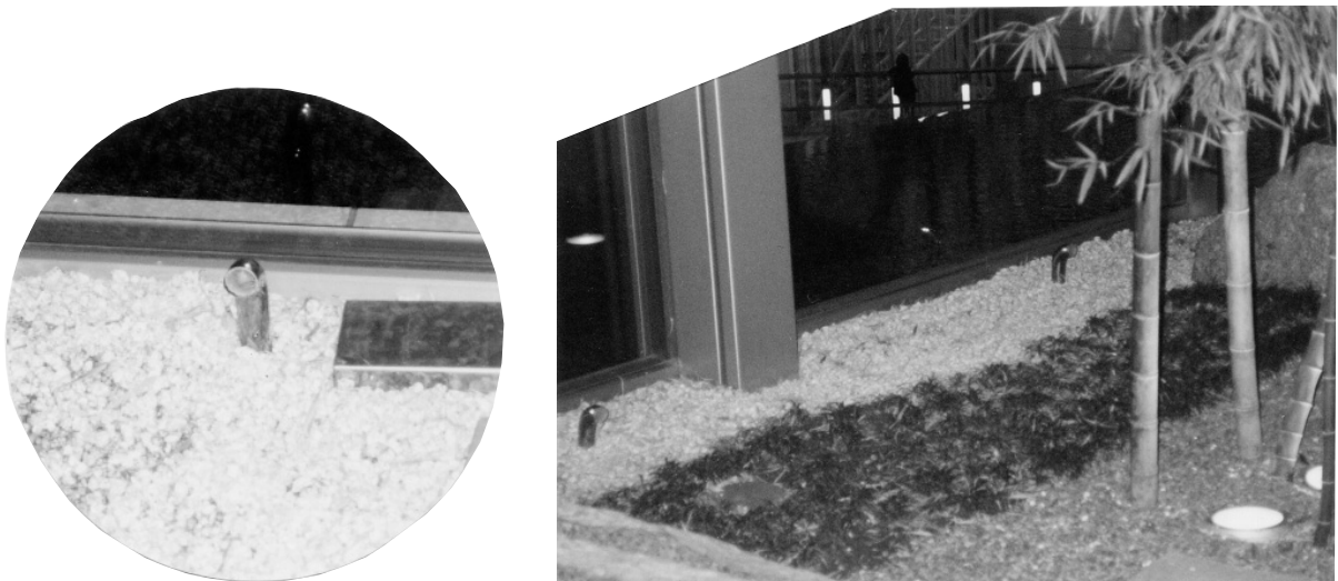
図 5.5.1.1 土の中に設置されたパイプスピーカ
